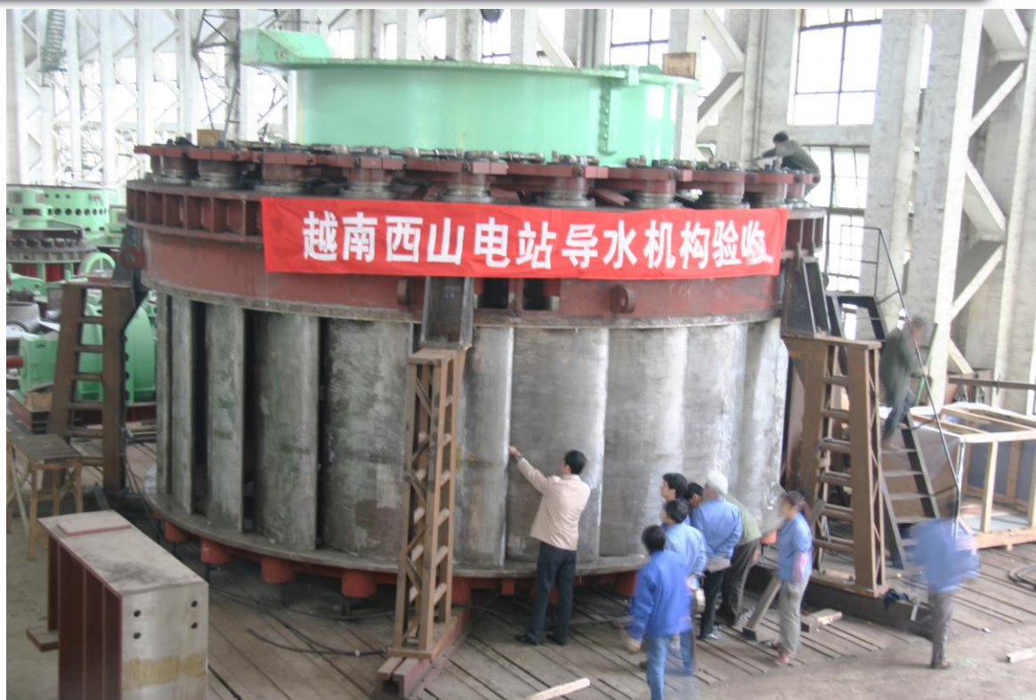
越南西山电站 Trạm thủy điện Tây Sơn Việt Nam
